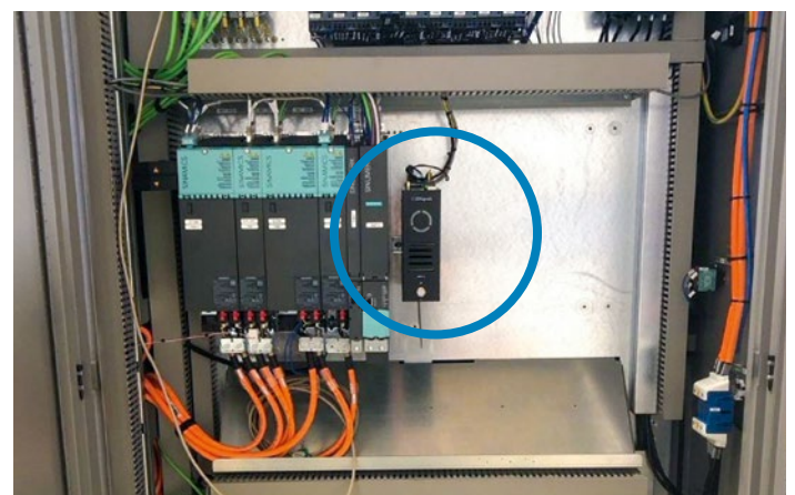
Abbildung 19: Anbringung des Vibrationssensors, des Stromwandlers und des dEdge
